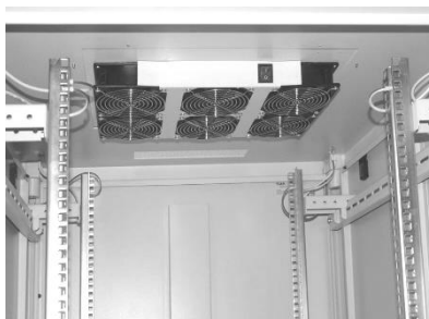
Установленный вентиляторный блок в шкафу
