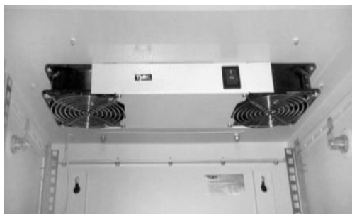
Установленный вентиляторный блок в шкафу
